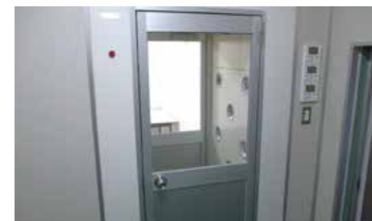
▲空気清浄設備の一部
