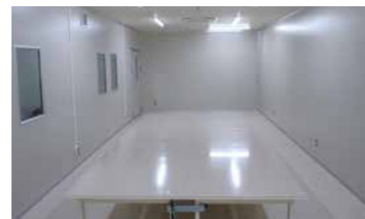
▲空気清浄設備が導入された作業場
