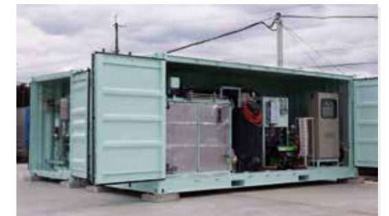
▲コンテナ内に必要な設備を収納
