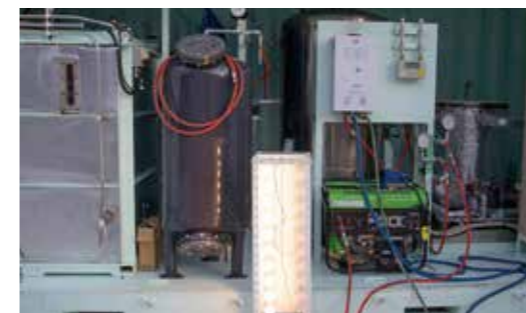
▲メタンガスを利用した発電
