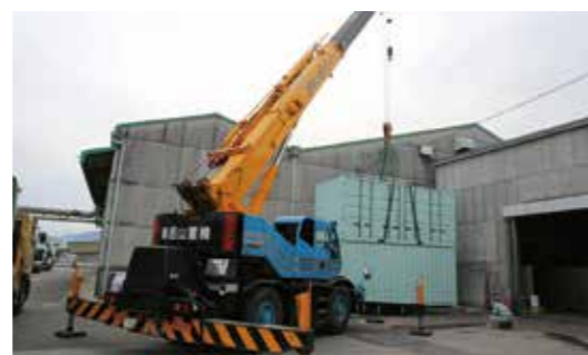
▲メタン発酵設備導入の様子
